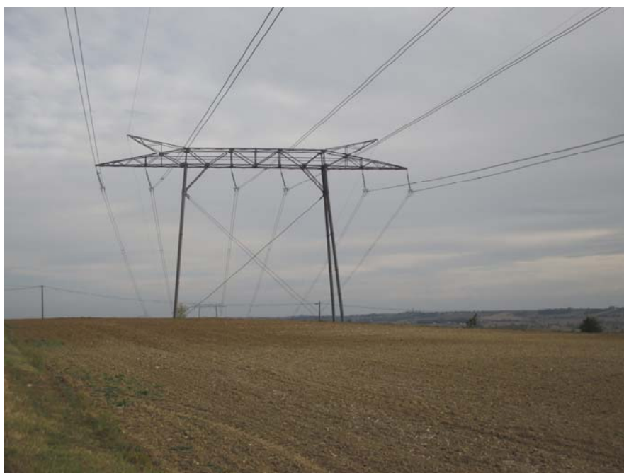
Illustration n° 33 : vue sur la ligne électrique Haute-Tension
