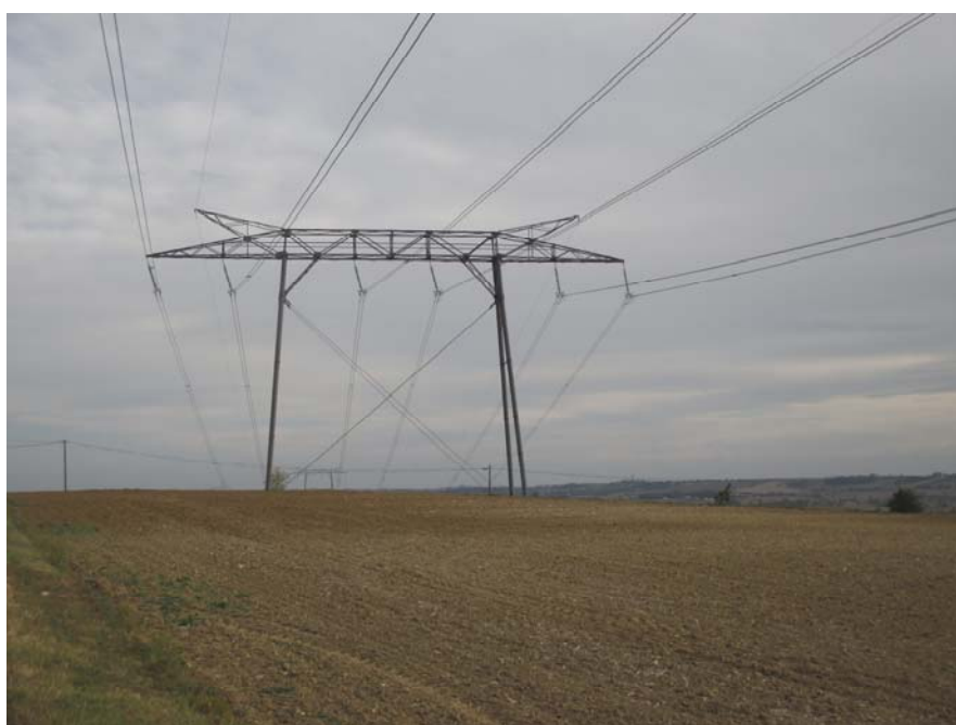
Illustration n° 33 : vue sur la ligne électrique Haute-Tension
